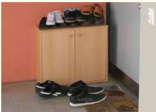
Das Treppenhaus ist kein Lagerraum!
